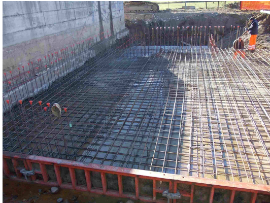
Foto prima dell'intervento
