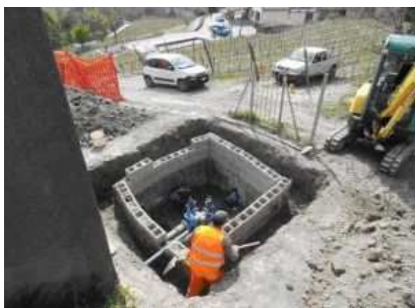
Gruppo idraulico serbatoio in Comune di Ozzano (AL)
